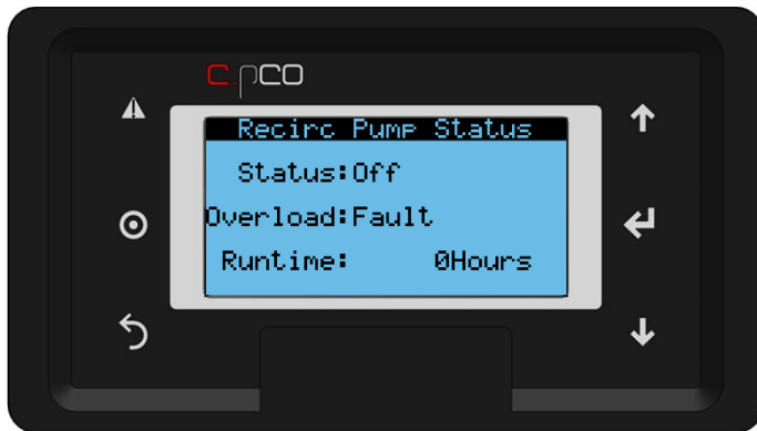
Figura 23: Dispositivos, estado de la bomba de recirculación
