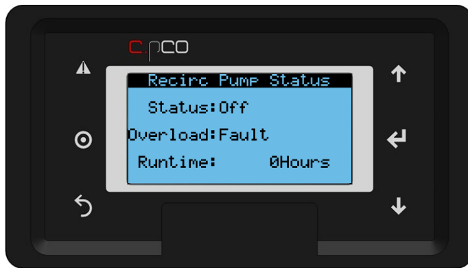
Figura 23: Dispositivos, Estado da bomba de recirculação
